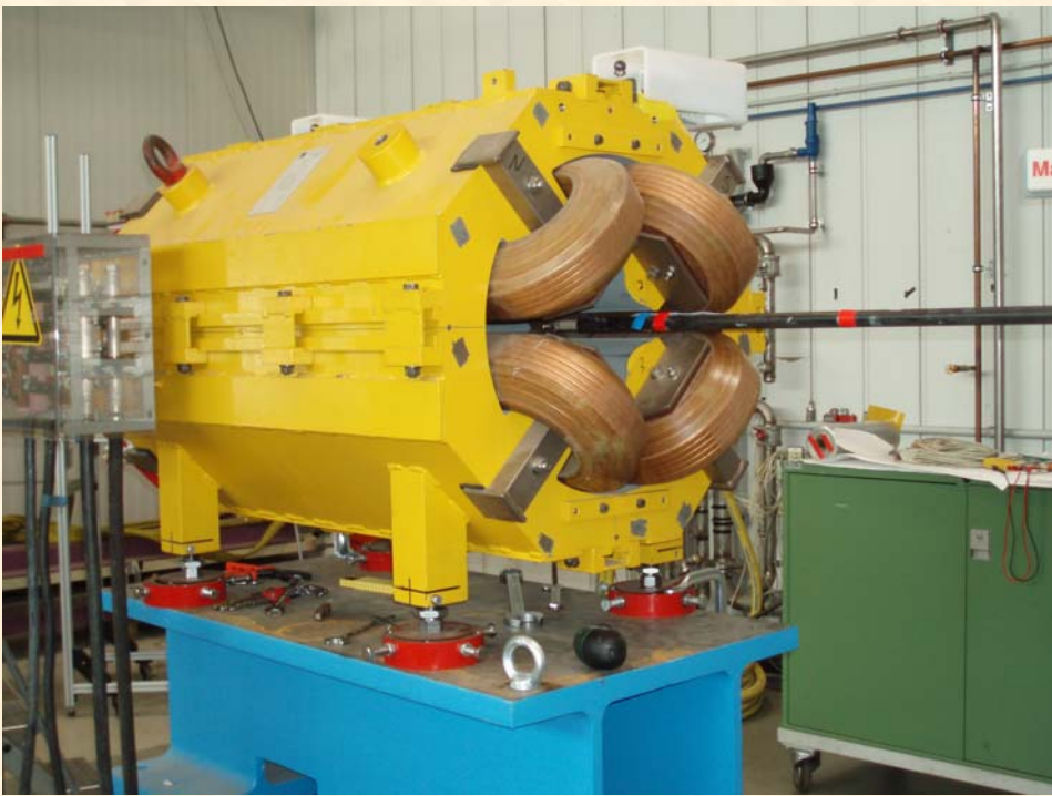
Fig. 2.6: Ein Standard-Quadrupol wie er im SIS18 installiert ist.
